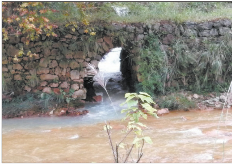
图为鱼洞某煤矿遗留矿井出水点(直排酸性废水355万吨/年)。
