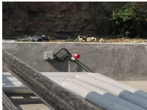
储罐区火灾报警装置
