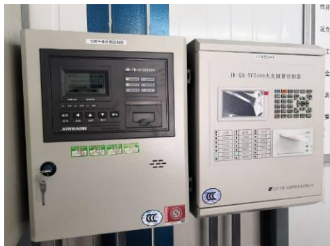
可燃气体检测及火灾报警装置
