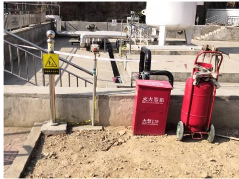
储罐区静电消除装置、灭火器
