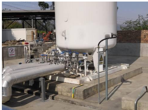
储罐区可燃气体监测探头
