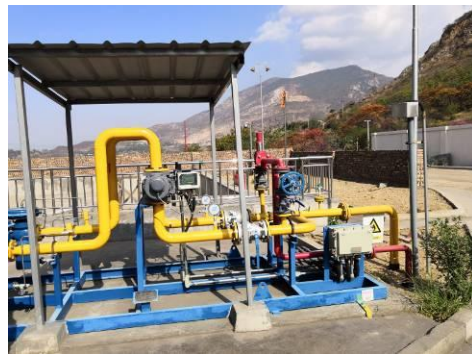
增加区可燃气体检测探头
