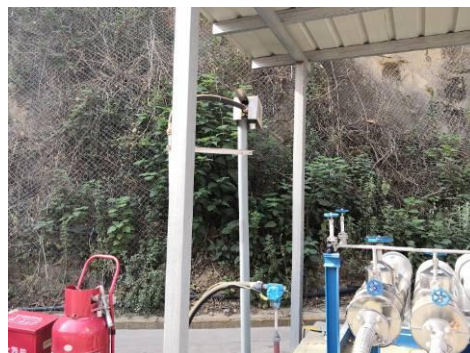
卸车区可燃气体监测探头
