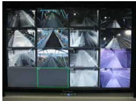
从七台FLIR A310红外热像仪中获取的画面和热图像被发送至PLC和控制室。
