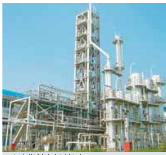
■伊泰煤製油中試基地。
