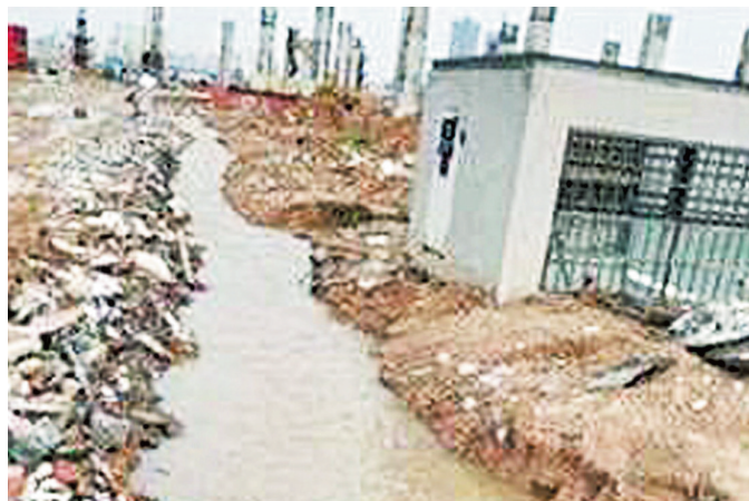
水浸现场人工开渠,导流退水。市三防部门供图
