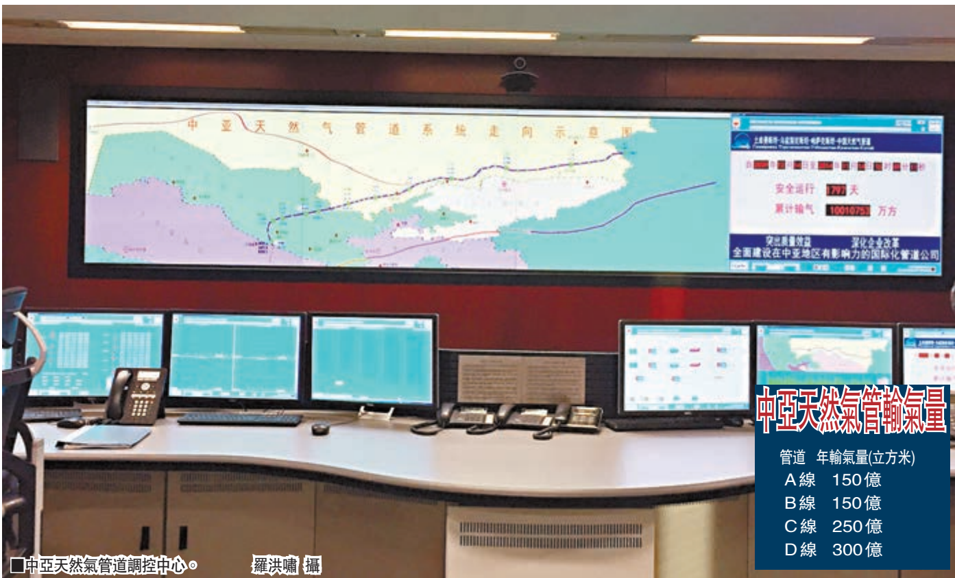
中亞天然氣管道調控中心。
