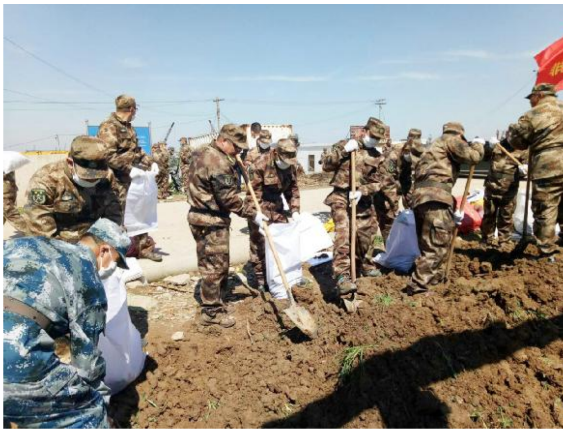
3月22日凌晨4时许,县人武部接盐城军分区命令,组织机关部分干部职工和合德镇民兵应急排赴响水县东港一化工厂事故现场紧急救援,他们主要担负挖土、运沙包、筑防化药品泄露堤坝等任务。
