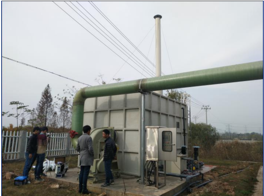
恶臭气体收集排放
