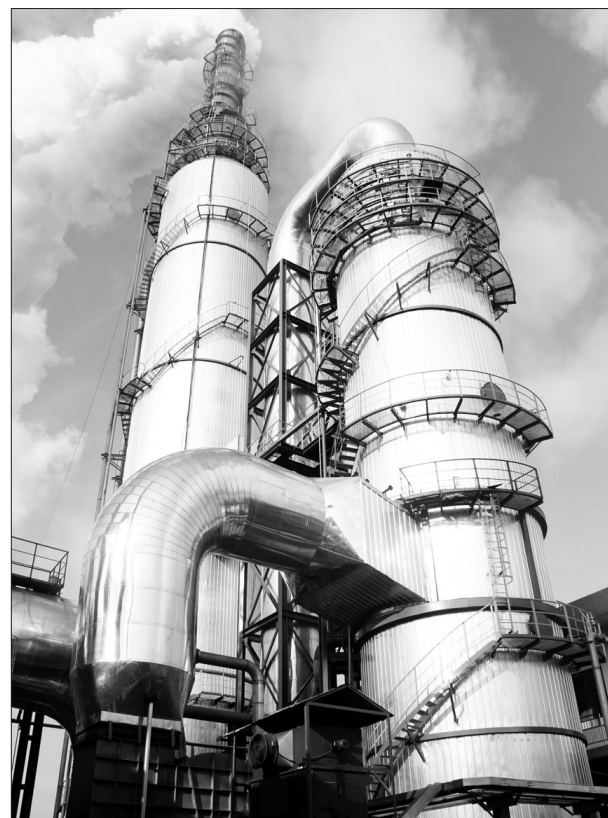
1号~5号焦炉脱硫脱硝塔
