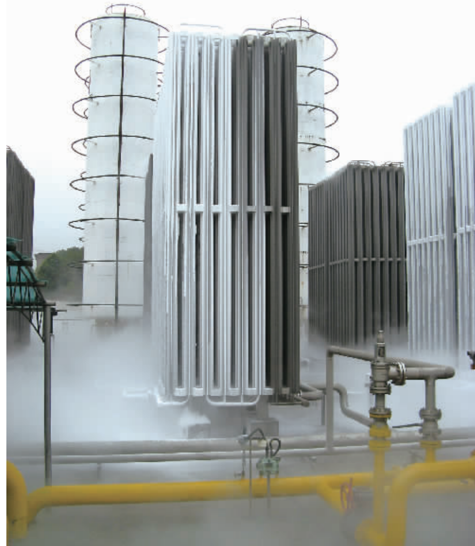
长沙新奥星沙120万立方米LNG站液化天然气气化时的情景。周灿摄
