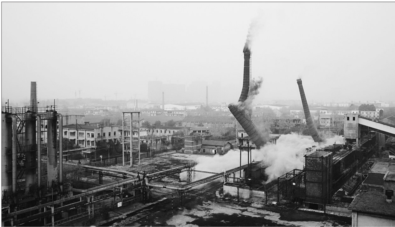
武汉市打响新年治霾“第一炮”。近日,武钢集团江南燃气热力公司服役近40年的3根烟囱被爆破拆除,每年可减少排放二氧化硫221吨、氮氧化物64吨、烟尘265吨。图为烟囱爆破瞬间。 杨志于 海涛摄
