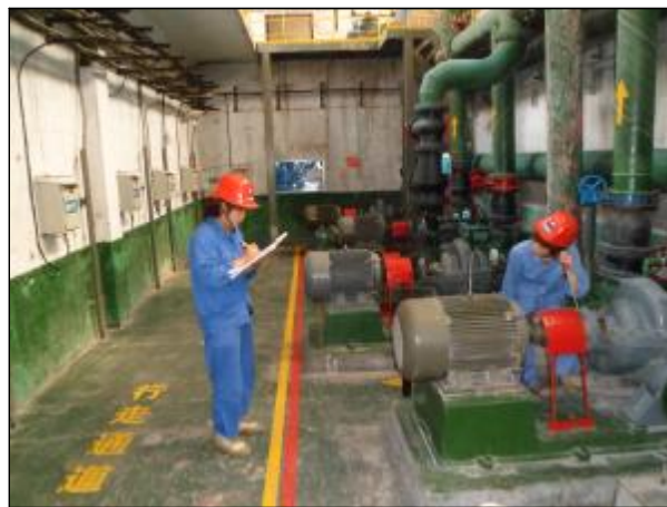
近日，水电分厂一车间对生产现场标示、操作标准流程、生产过程控制等实施目视化管理，各班组生产现场区域、仪表、工具等标识清晰；岗位操作流程、应急预案全部上墙，清晰可视，方便员工学习操作；岗位关键指标实时控制，记录真实；切实提升了车间现场管理水平。图为车间焙烧炉泵房员工按照目视化要求精心巡检设备。
