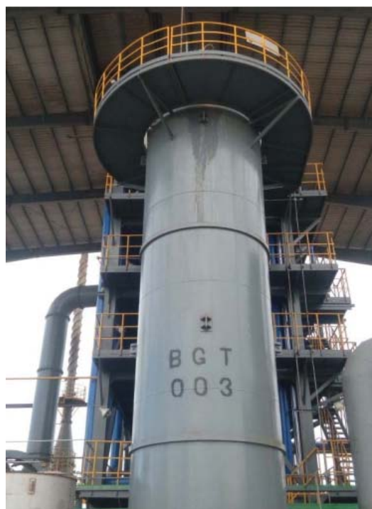
半干式急冷脱酸塔
