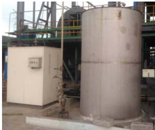
尿素溶液储罐及控制系统
