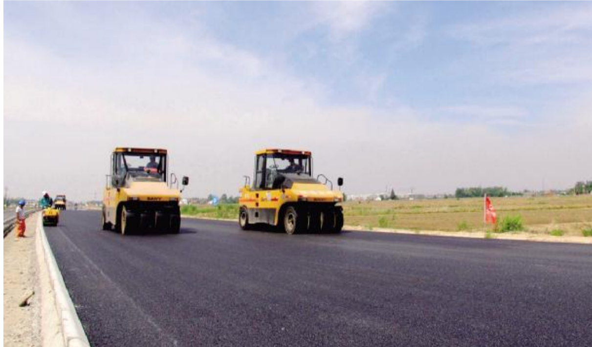
年初以来，我县强势推进交通八大类33项重点工程建设。相关施工单位抢抓晴好天气，倒排工期，挂图作战，确保超序时完成目标任务。图为射阳至建湖路(省道233)建设现场。 记者 成杰 摄
