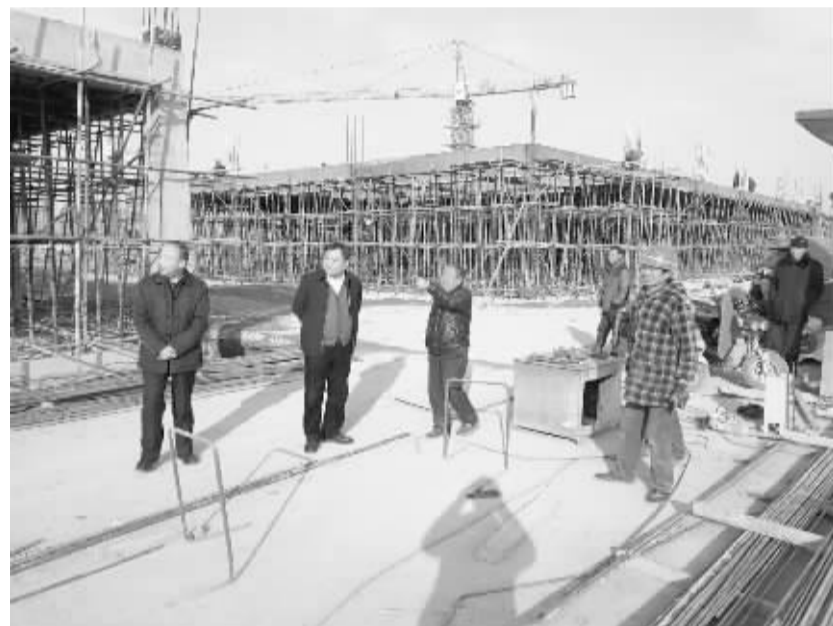
2月10日,太康县委书记王国玺,人大主任张思民,县委常委、县委办公室主任董鸿,先后来到河南磊磊纺织有限公司针织面料生产建设项目和河南润泰纺织服饰有限公司服装新区建设项目工地进行调研,详细了解项目工程进展情况。刘俊涛摄
