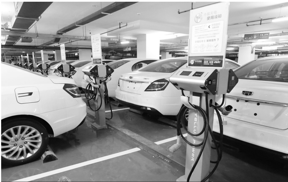
为推进充电桩建设,《行动计划》将审批制变为备案制,简化手续。 本报记者邓佳摄
