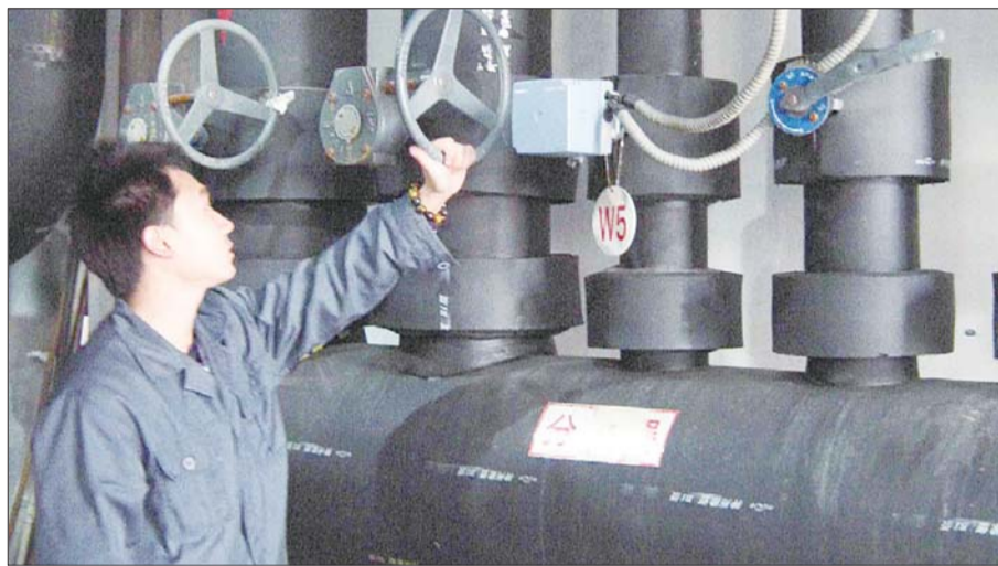
地下水循环的热量从这里输入大楼。本报记者 李楠楠 摄
