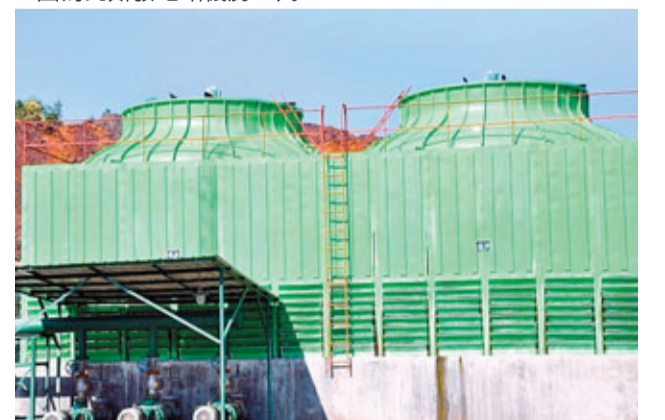
■圖為瓦斯發電站高溫冷卻塔
