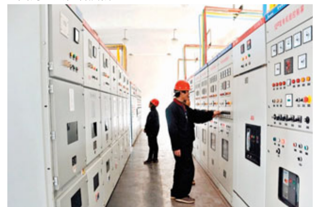
■圖為瓦斯發電站機房一角
