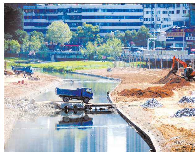
在湖北省十堰市神定河蓬布厂段整治工程现场,大型机械、车辆在河道上回填黄土,平整河床。十堰市从2018年年底开始对神定河进行综合整治和精准治污,兴建生态水利工程,砌筑挡墙驳岸,绿化沿河堤岸,打造河道绿色景观文化长廊。 薛乐生摄
