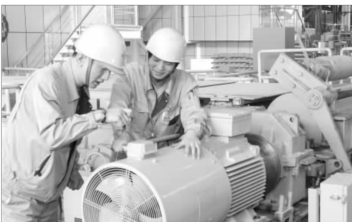
工程技术公司宝菱电气充分利用企业技术优势,为华东地区冶金、化工、地铁、物业等领域的用户开展东芝三菱电气系统的技术服务。今年以来,该公司共派出技术人员现场服务达2100人次,受到好评。图为技术人员正在进行现场服务。记者 陆非然 摄影报道
