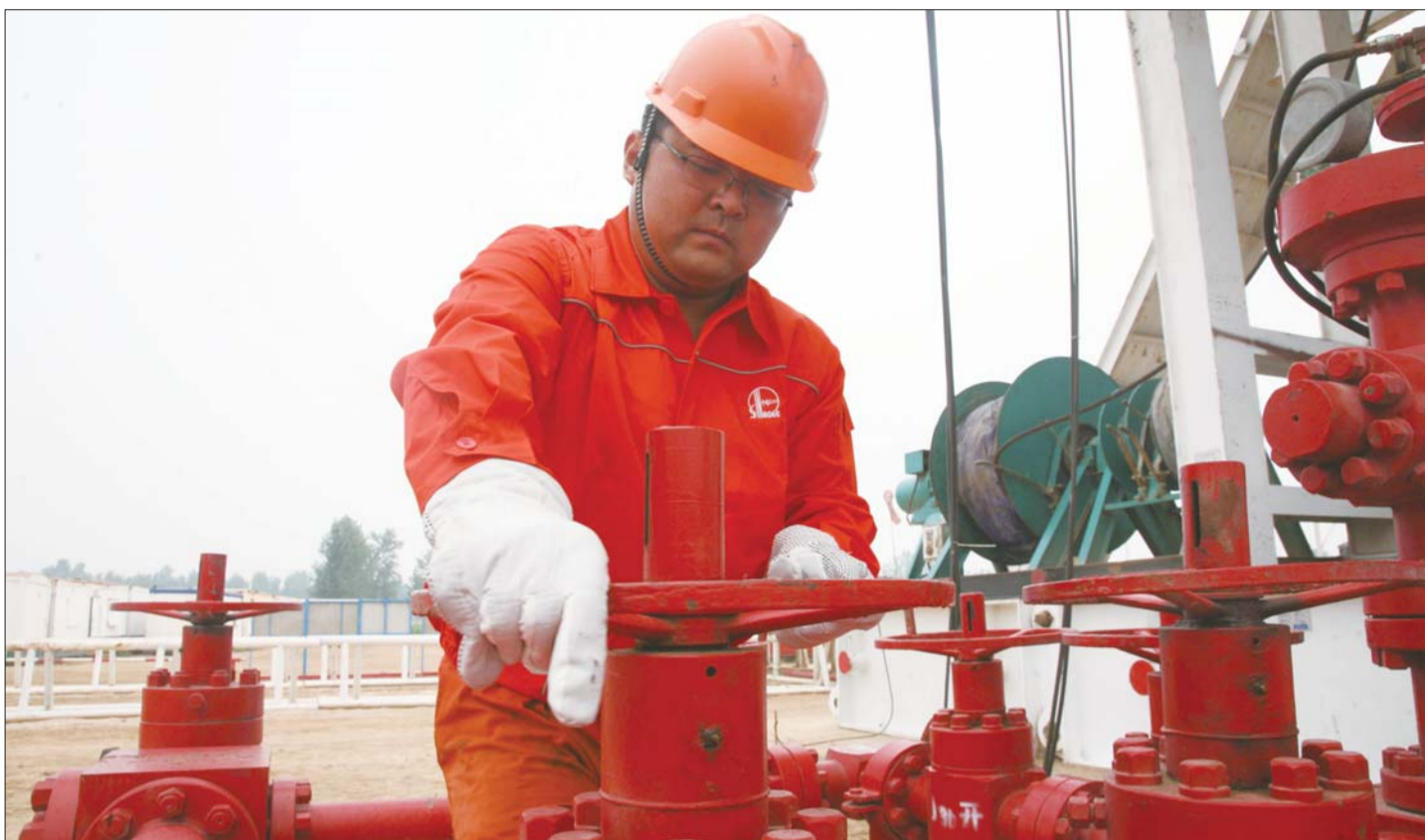
薛友强正在进行倒闸门操作。
