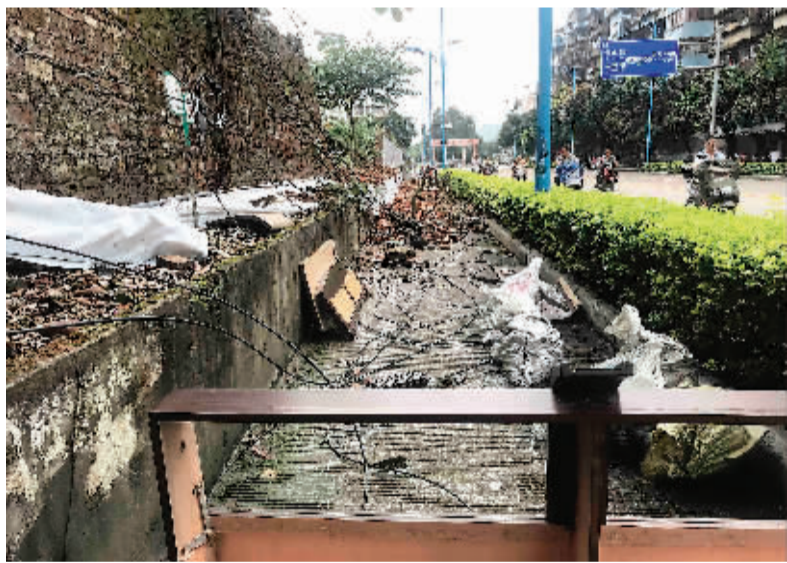
倒塌的围墙堵住了非机动车道。记者周子琪 摄
