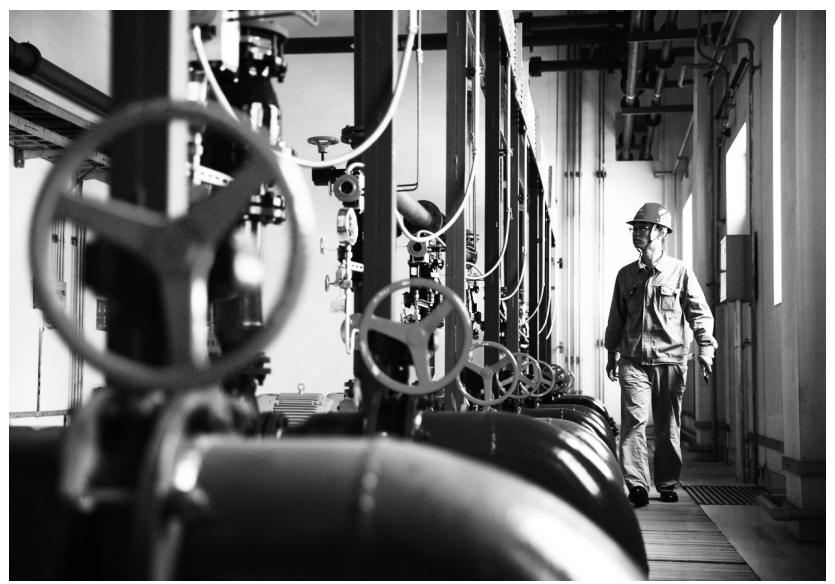
内蒙古岱海发电有限责任公司员工正在巡检环保设备。
