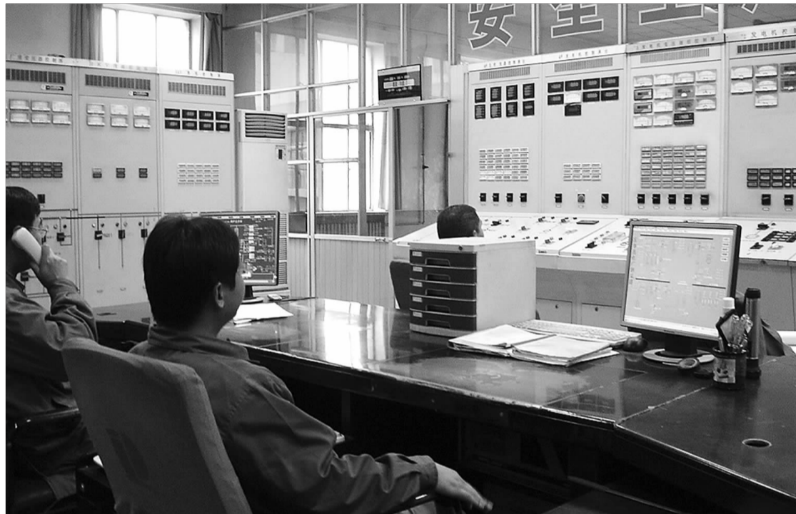
济宁东郊热电厂的工作人员正在严密监控供热设备的运转情况。
