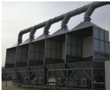
图 4 安装防尘设施的进料仓
