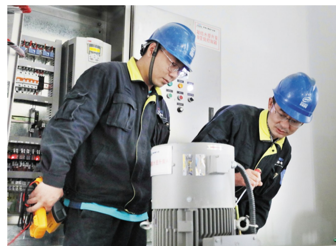
华美热电公司淮海大数据项目实施中央空调冷凝水回收利用工程,在变废为宝的过程中实现了废水循环利用和水污染治理。图为该公司技术人员对改造后的冷凝水回收系统进行安全检查。 本报记者 孟婕 摄
