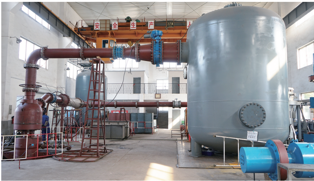
正在进行高温高压测试的炉水循环泵
