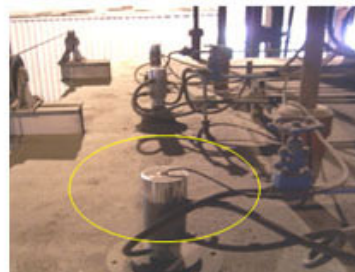
玻璃线测温系统
