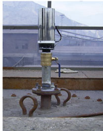
热风炉炉顶测温
