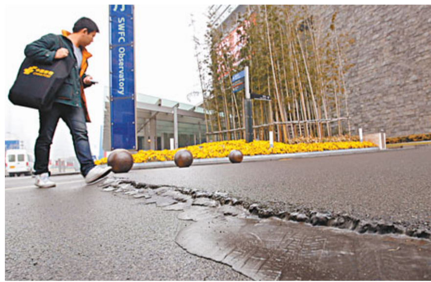
■上海陸家嘴在建上海中心大廈施工工地附近地面出現多處裂縫。圖為初步的灌縫修補後的路面。
