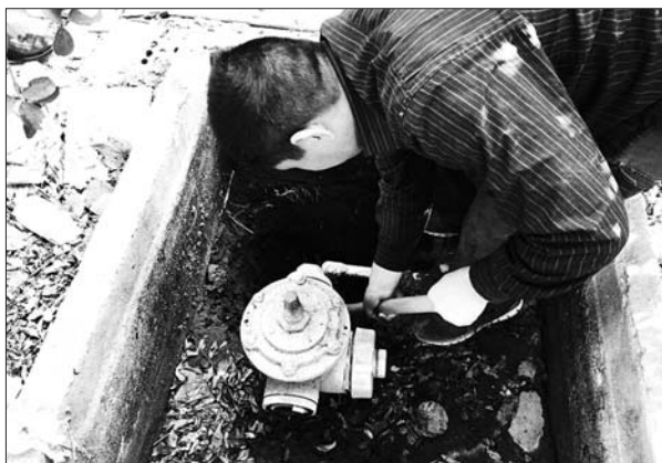
消防栓下,挖了半米露出私接自来水管。本报记者 康宇 摄
