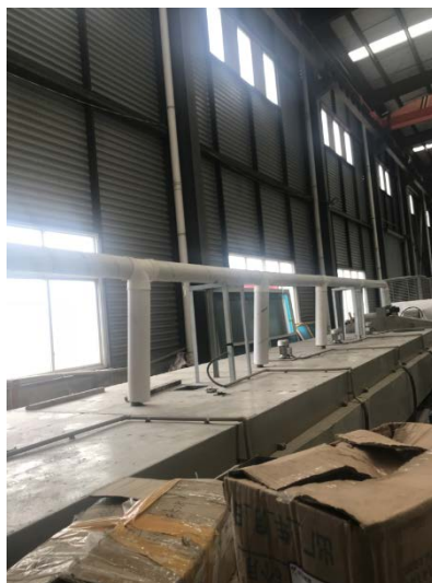
烘干上方抽风管道
