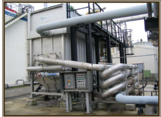
DAF(加壓浮除機)
