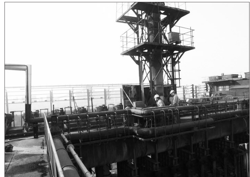
安徽淮北矿业临涣焦化公司建立完善燃煤除烟除尘、上升管水封等设备的定时定人检修制度,确保春节期间环保设备运转正常。 杨永才摄
