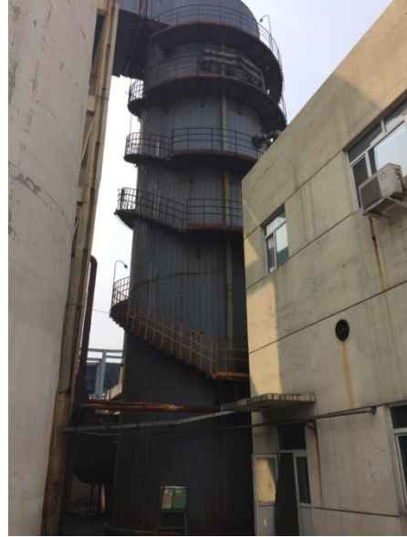
图片 2 4、5#锅炉脱硫塔
