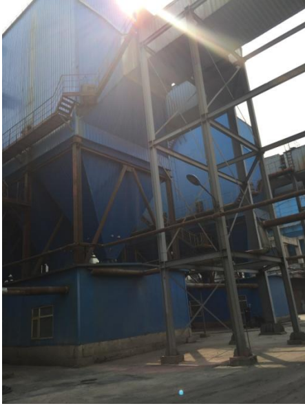
图片 1 4、5#锅炉除尘器
