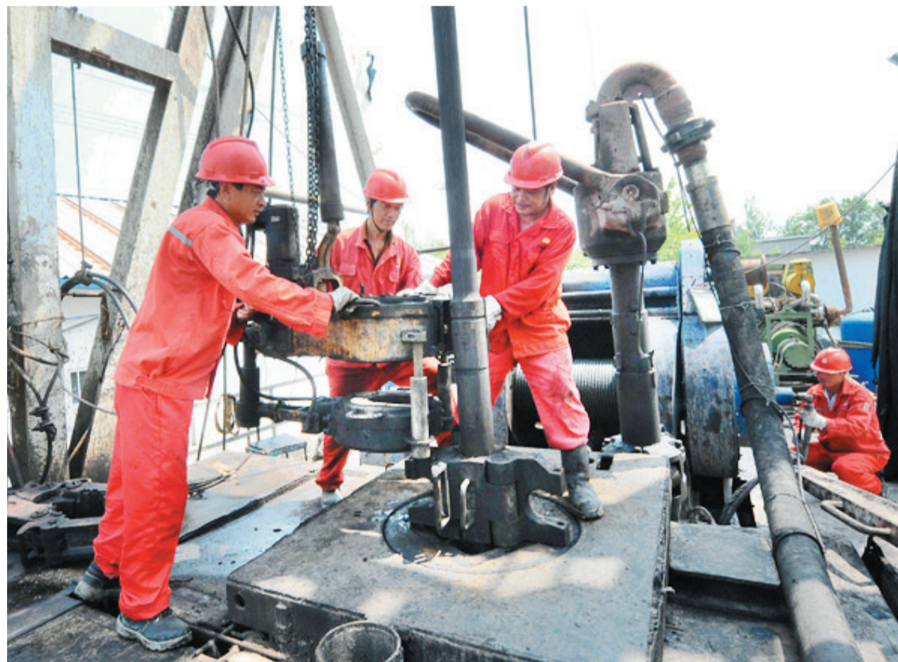
为全面提升瓦斯治理效果,淮南矿业与西安煤科院合作,实施地面钻井掏煤辅助消突工程,实现立体消突,井上井下瓦斯共治取得初步成效。图为施工工人准备下钻。 来源:淮南矿业网
