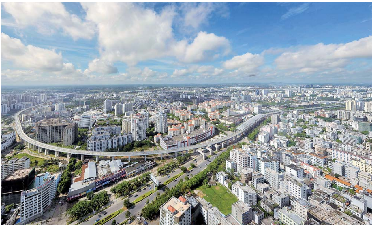
▲这是建设中的海南东环铁路海口段(2010年8月13日摄)。 新华社记者郭程摄
