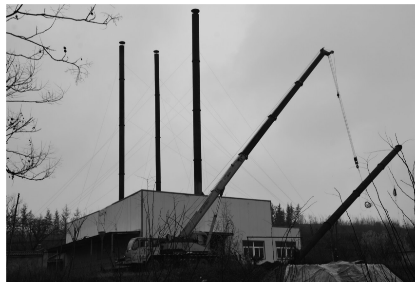
图为西安财经学院行知学院燃煤锅炉拆改现场。 王双瑾摄
