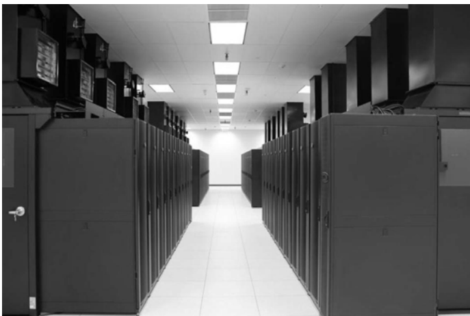
图 1-2 数据中心实景图
