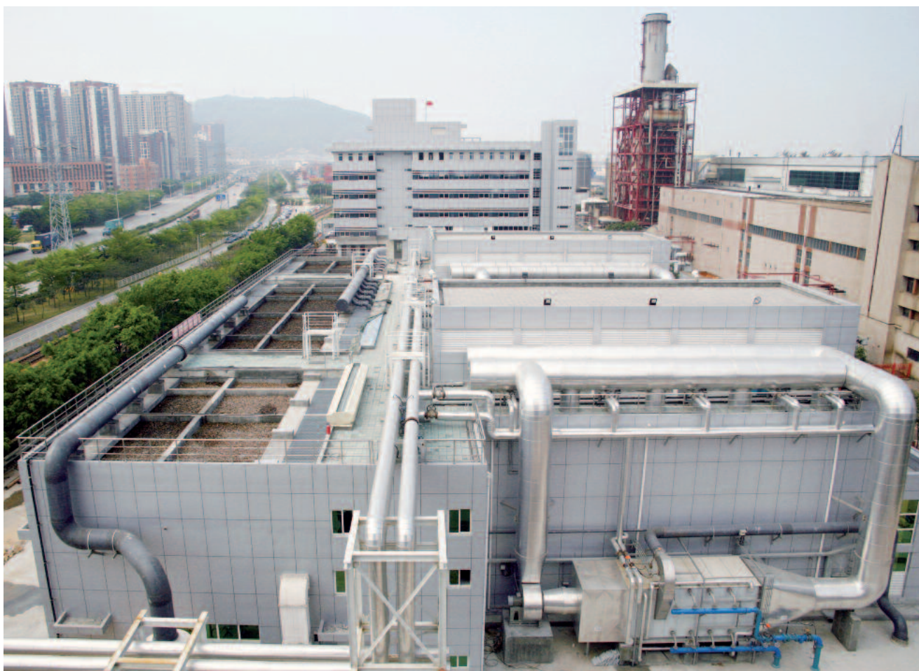
大型市政污泥干化装置，配置冷凝装置和生物滤床
