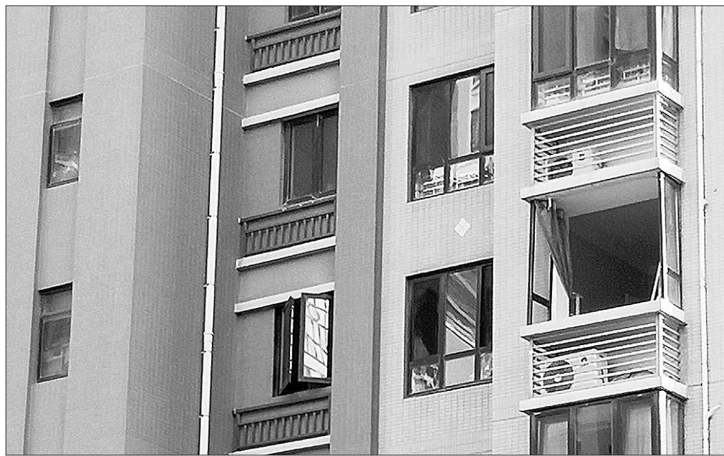
5楼住户多扇窗户因爆燃破损。
