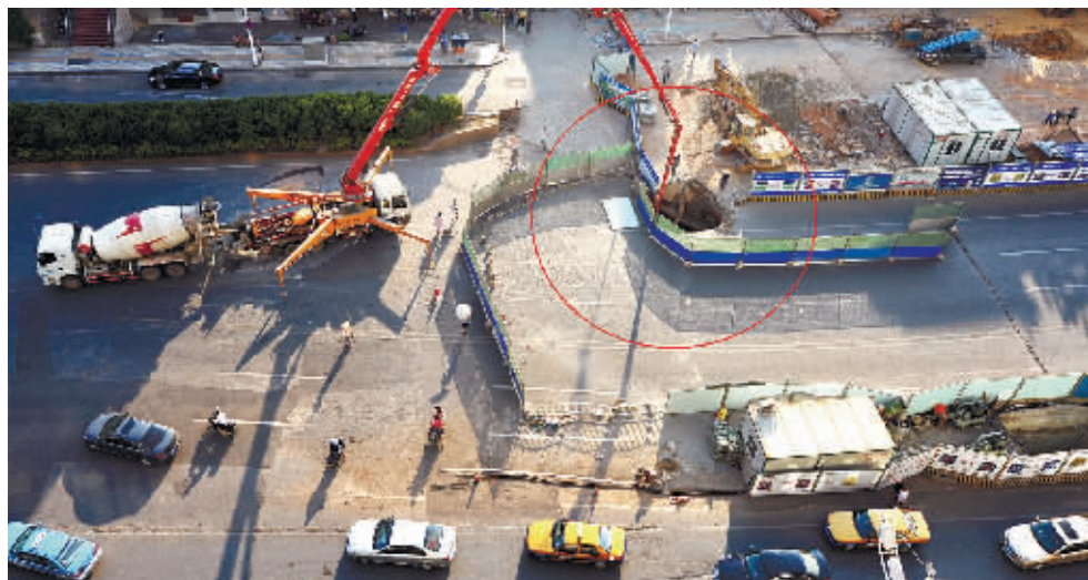
8月12日上午11时,长沙地铁一号线铁道学院站至涂家冲站盾构施工到达涂家冲站时,地表突然发生塌陷(红圈处),塌陷面积约5平方米,深度约5米。 三湘华声全媒体记者 李丹 摄
