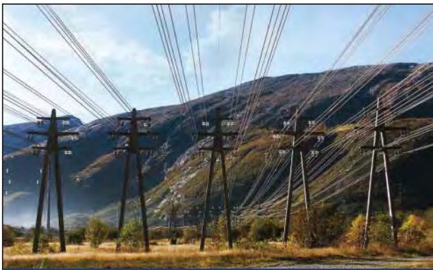
电力架空线监测
