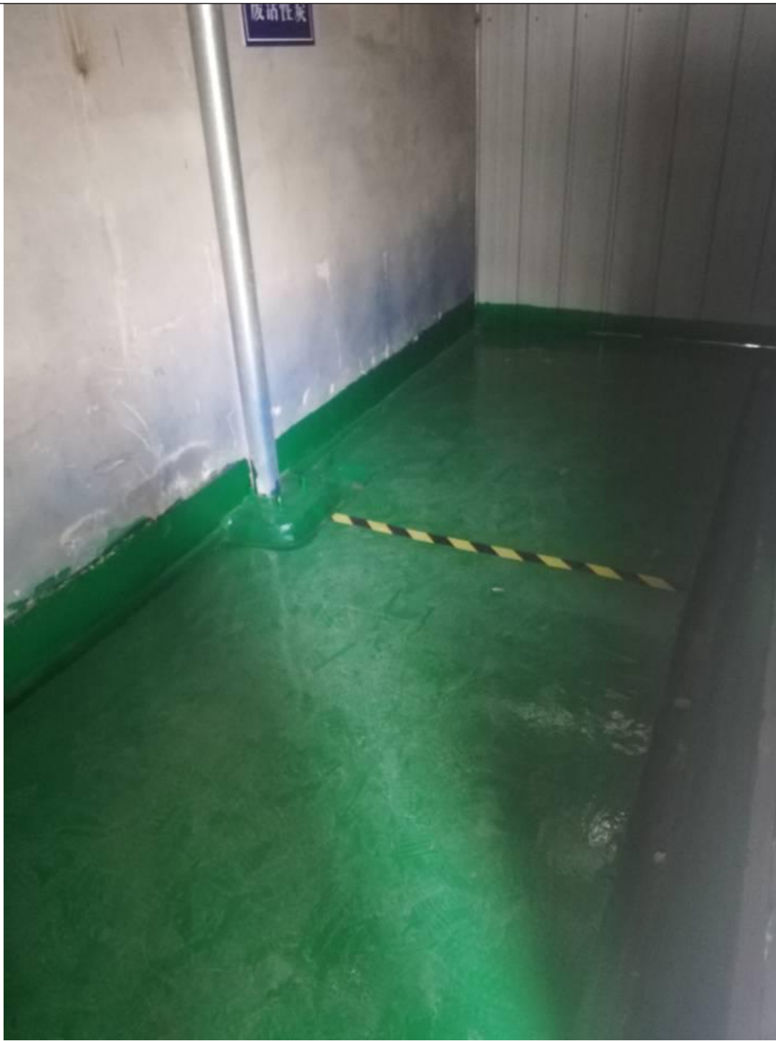
图3-2 危险废物暂存间内部照片
