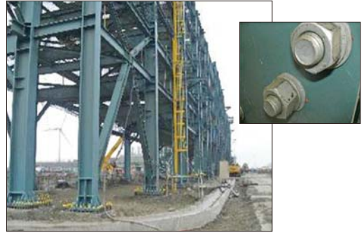
圖 5 公共管架 H 型鋼及高強度螺栓經熱浸鍍鋅 再噴塗防火漆
