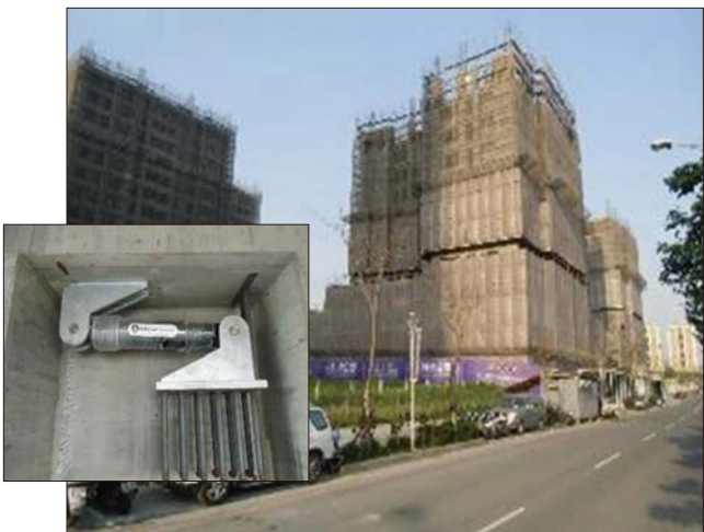
圖 9 大樓制震器固定座，經熱浸鍍鋅處理
