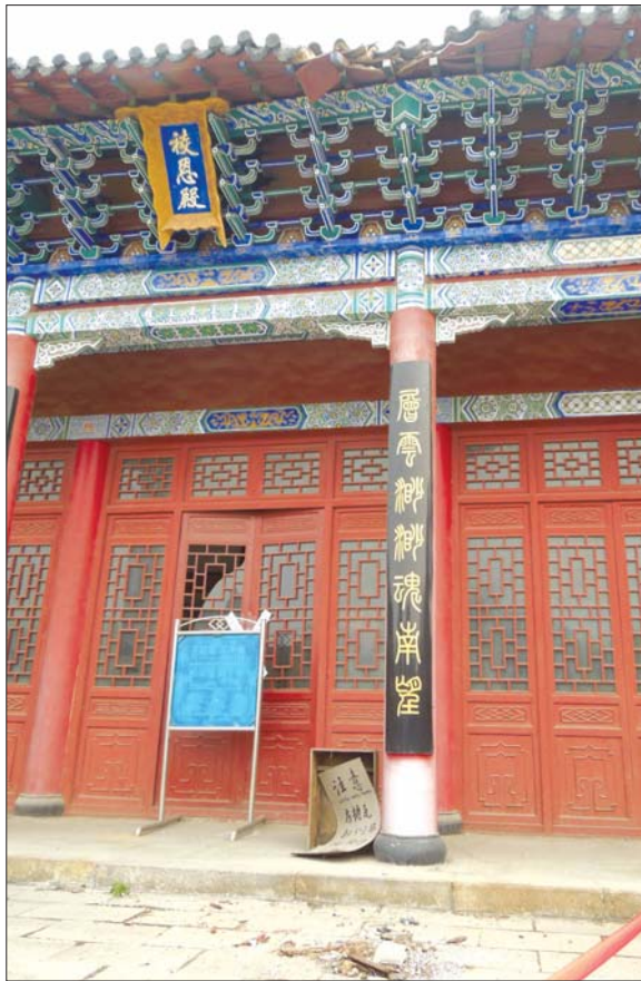
苏禄王墓景区掖恩殿的房檐瓦部分损坏,掖恩殿前后门已被相关部门贴上封条。 本报记者 刘振 摄
