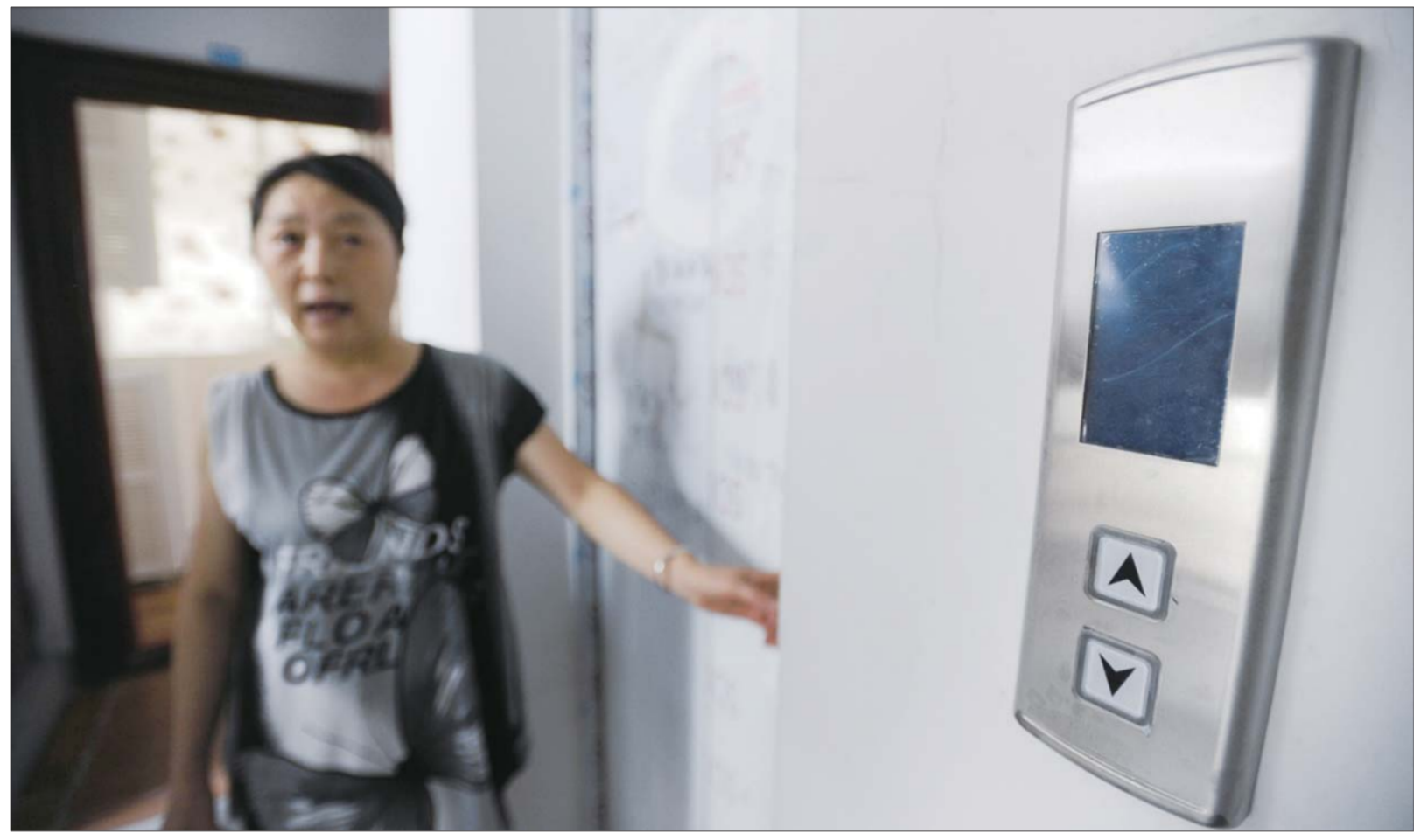
有些新小区的电梯故障不断,图为一小区的电梯出现故障,上面的数字不再显示。(资料片) 本报记者 王媛 摄
