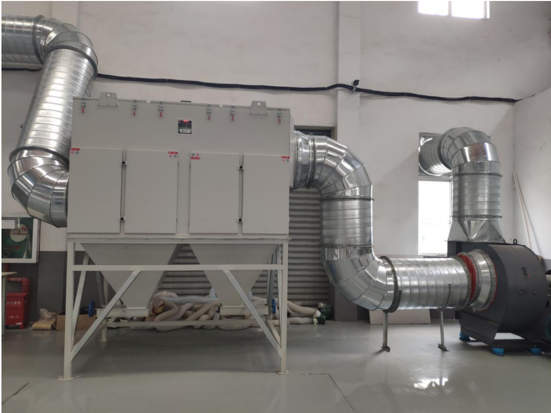
图4-3 废气处理设施
