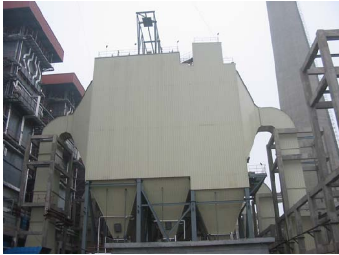
▲ 3 电场（即将除尘器分为 3 个部分）组合构造。左侧的 2 个电场是固定电除尘器，右侧的 1 个是移动电极静电除尘器
