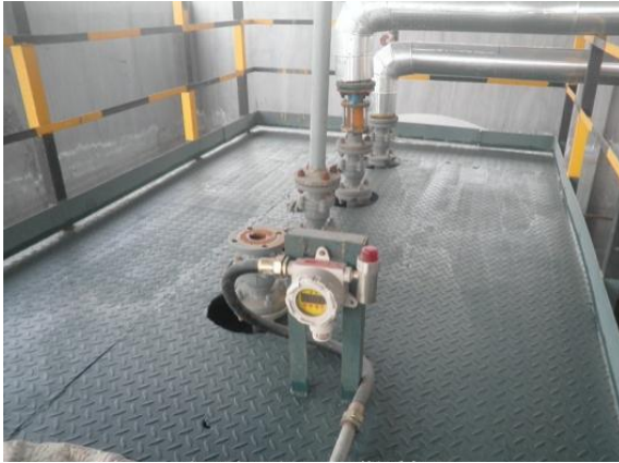
气体泄漏报警装置
