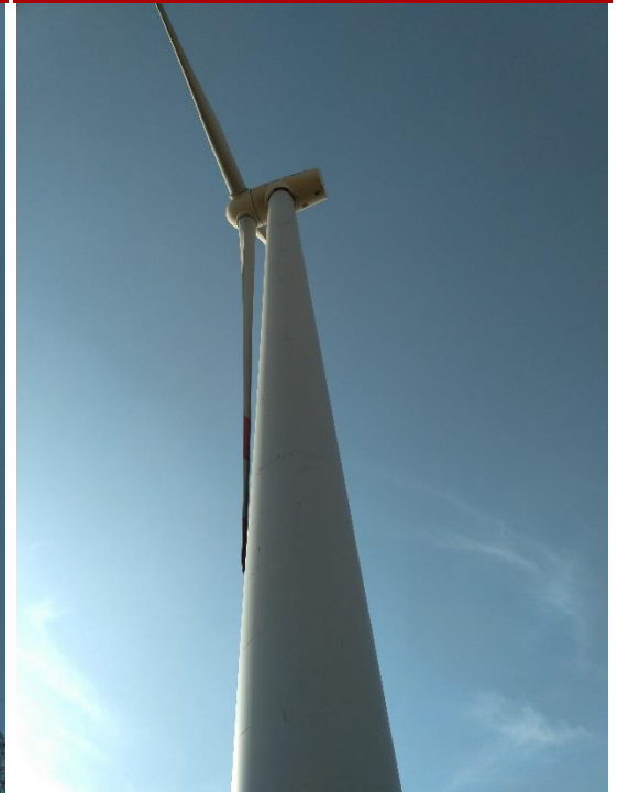
图表 9：辽宁铁岭大兴风电场
