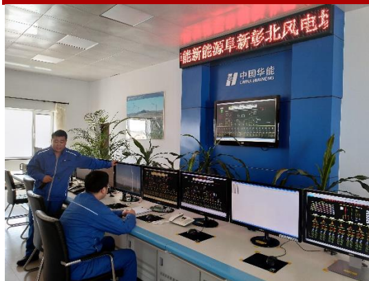
图表 10：辽宁彰北风电场的控制室
